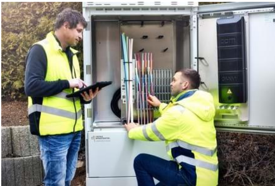
Bauleiter des Eigenbetriebs Digitale Infrastruktur überprüfen einen Netzverteiler. In diesen Verteilerkästen werden die Glasfaserkabel der einzelnen Häuser zusammengeführt
