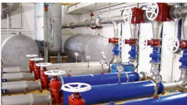
Rohrkeller im Hauptpumpwerk
