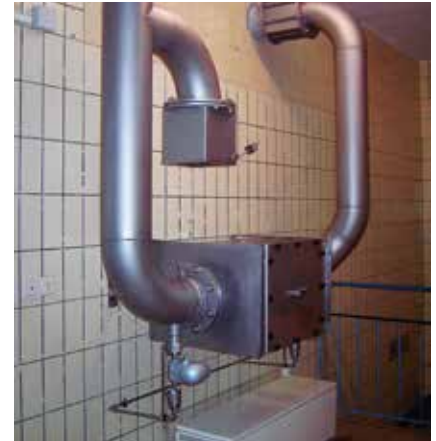
Belüftungsanlage für die Wasserkammern
