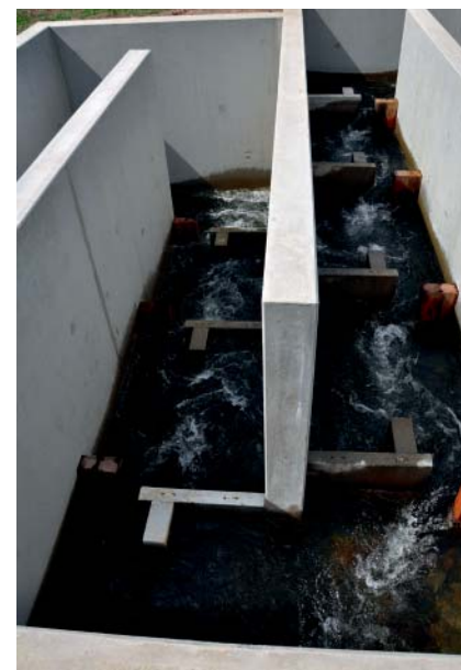
Schlitzpass nach der Inbetriebnahme als Fischwanderhilfe
