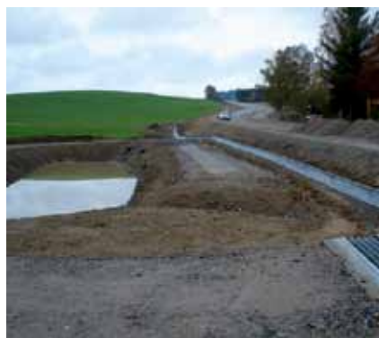
Amphibienleiteinrichtung mit Regenrückhaltebecken
