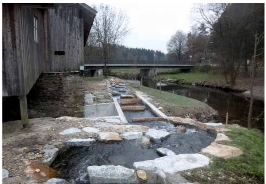
Mit dieser Fischwanderhilfe in Form eines Raugerinne-Beckenpasses wurde die Durchgängigkeit des Gewässers Weißer Regen im Bereich der Wasserkraftanlage Hohenwarther Mühle durchgängig gemacht
