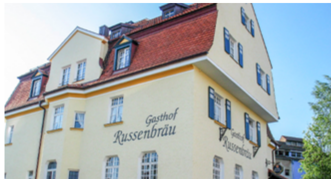
Markus Bücherl für die Fassaden- und Dachsanierung vom Gasthof und Hotel „Russenbräu“ in Tiefenbach
